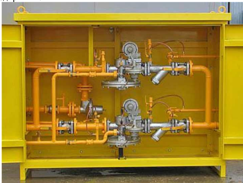
Рисунок 5.3.3. Общий вид шкафа для регулирования газа (ГРП)
