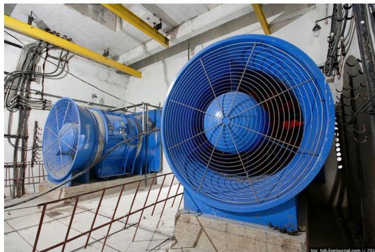
Рисунок 9.2 – Осевые вентиляторы главного проветривания
