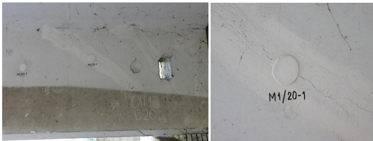
Рис. 1. Маяки, установленные на трещины в приопорной зоне балки Б-20 пролета №1.
