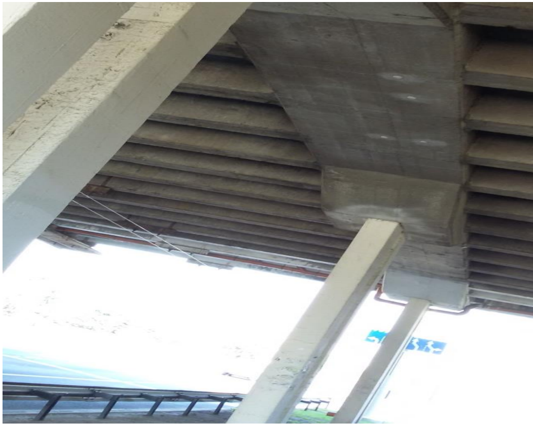
Рис. 3. Маяки, установленные на трещины по бетону ригеля опоры №4.
