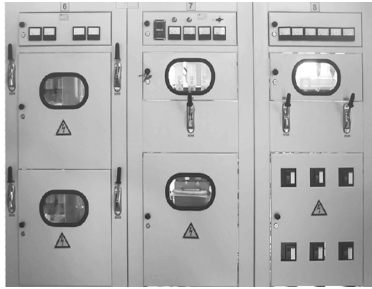
Рисунок 4.2 - Общий вид распределительного щита типа ЩО (П)
