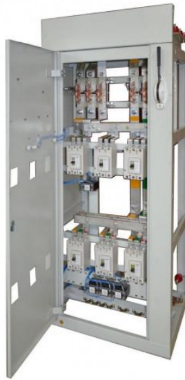
Рисунок 4.3 - Общий вид панель распределительного щита (с автоматами)
