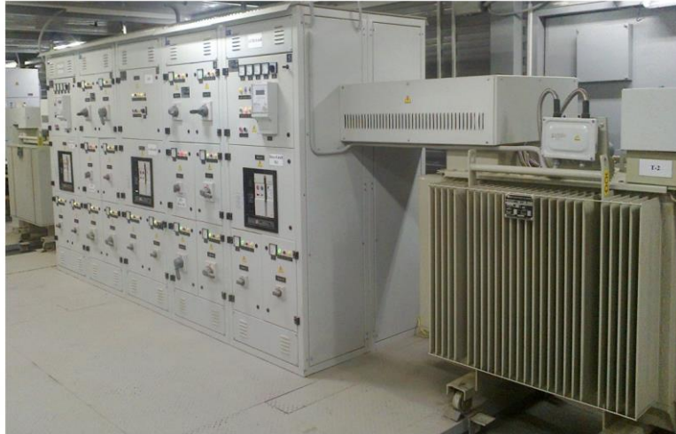
Рисунок 4.5 – Распределительного устройства низкого напряжения КТП
