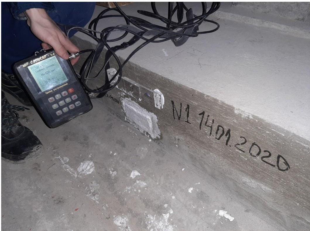
Рисунок 7 – Трещина №1 в конструкции путевого бетона перегонного тоннеля.
