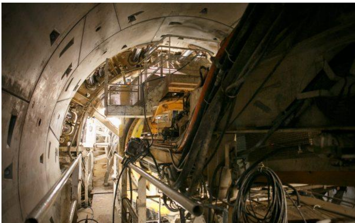
Рисунок 3 – Щит «Алеся» изнутри
