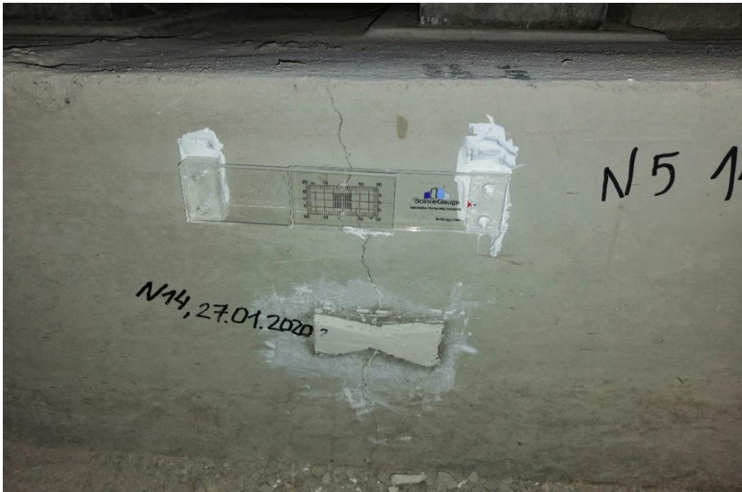
Рисунок 6 – Общий вид пластикового и гипсового маяков, установленных на трещине
