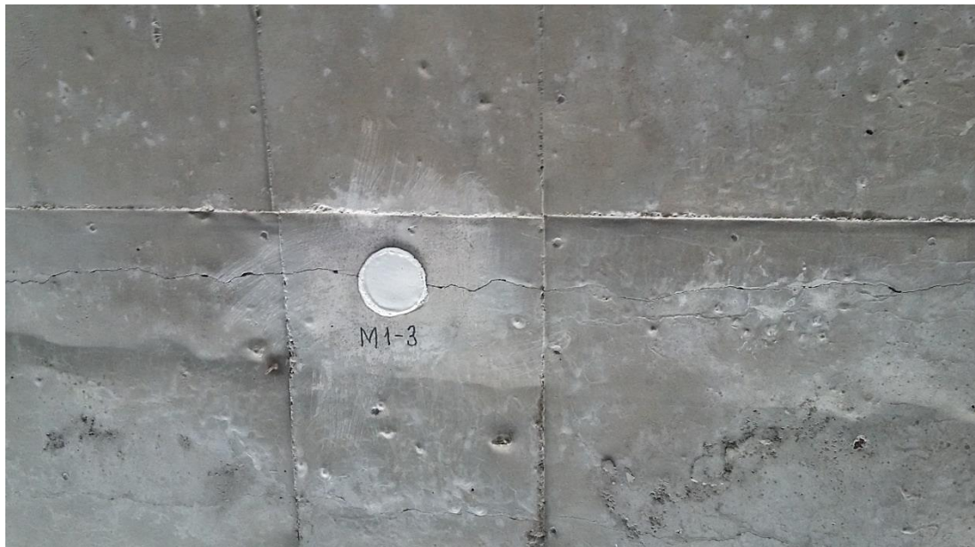
Рис. 4. Маяк, установленный на трещину по бетону ригеля опоры №3.
