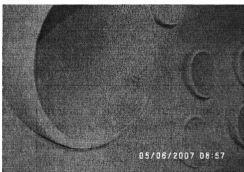
Состояние верхнего барабана парового котла до внедрения АС-СОВ
