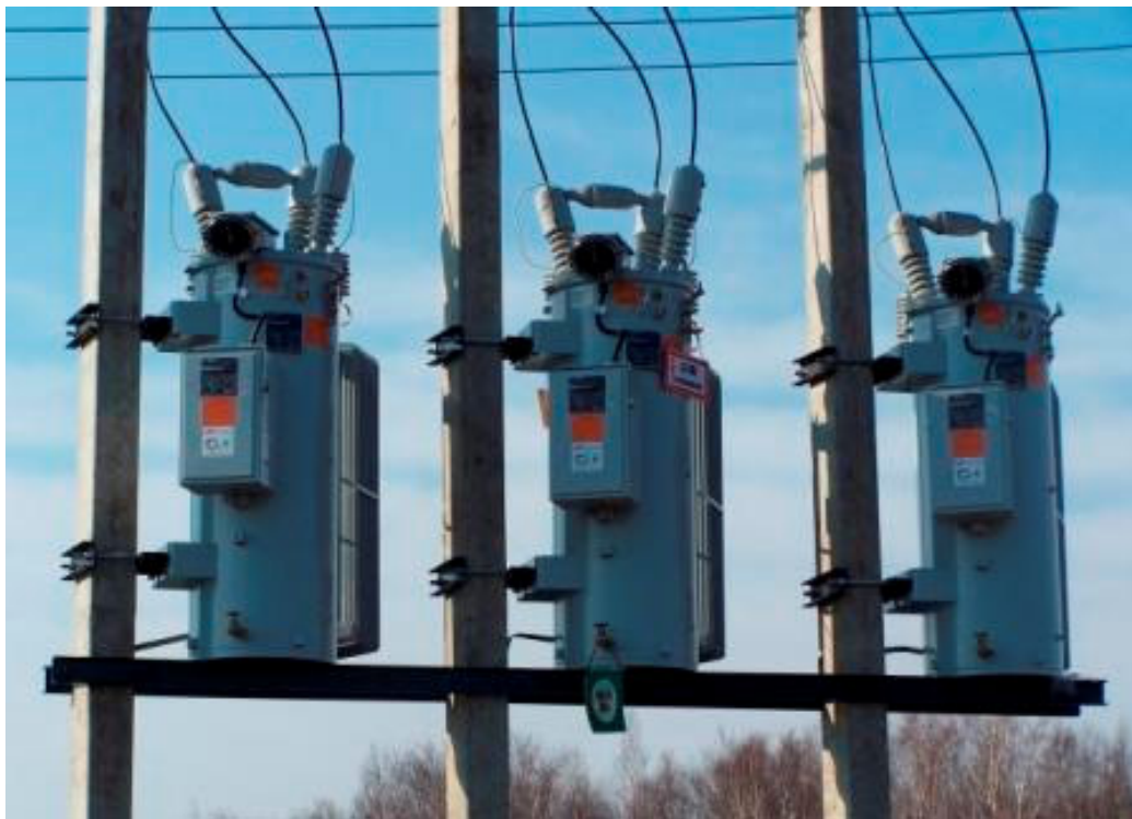
Рисунок 3 – Пункт автоматического регулирования напряжения типа ПАРН-ВДТ-СН
