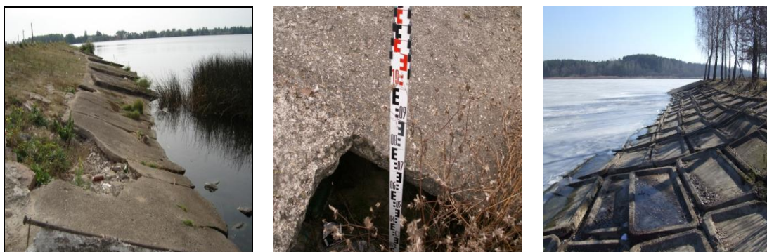
Рисунок – Характерные разрушения крепления откосов
