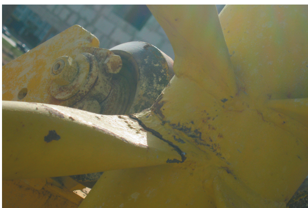
Рис.3. Развитие усталостной трещины, предшествующее разрушению сварного соединения
