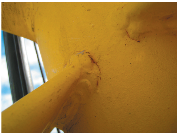
Рис.2. Зарождение усталостных трещин
