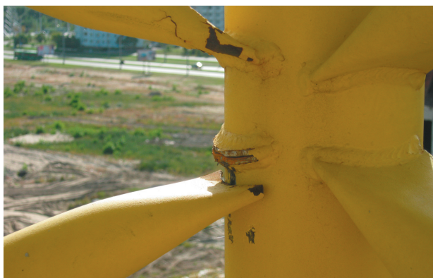
Рис. 4. Разрушение сварного соединения
