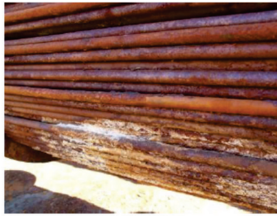
Рисунок 2 – Корозійні відкладення в нижній частині трубного пучка із сталі 15Х5М
