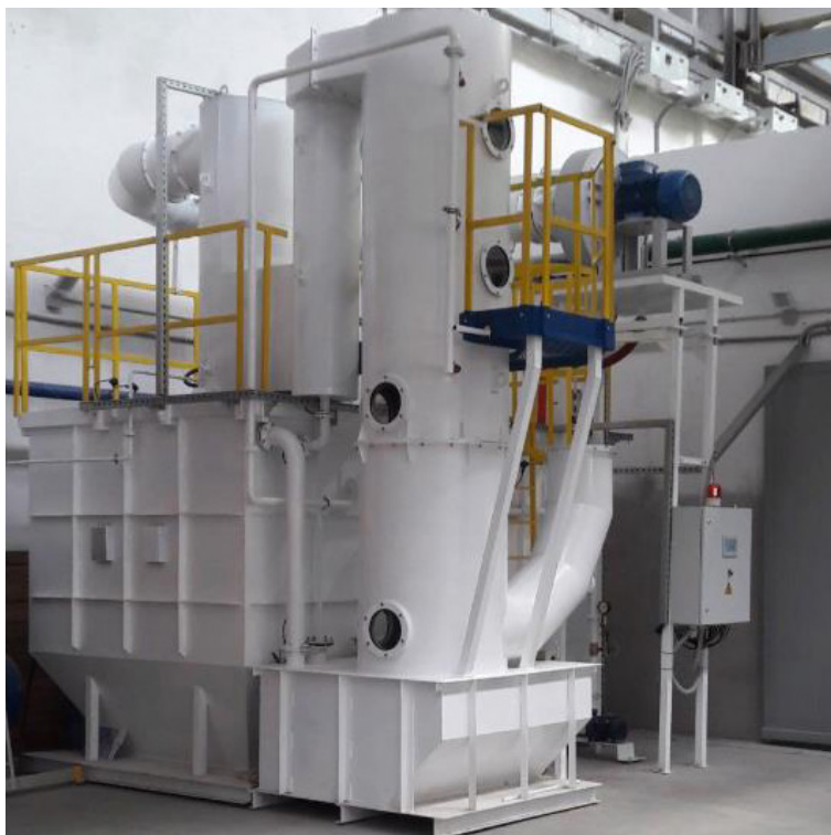
Рис. 2. Действующая установка очистки отходящих газов в литейном производстве
