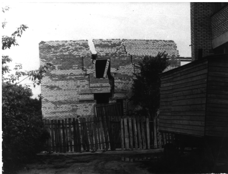
Рис. 40. Разрушение здания «Беларусбанка» в г. Шарковщина на склоне возле реки вследствие оползня, активизировавшегося при динамических воздействиях от забивки свай и разжижении ила в их основании
