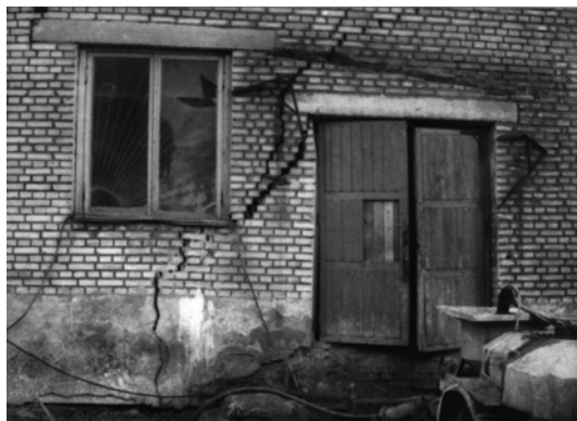
Рис. 48. Разрушение здания на участке мульды
