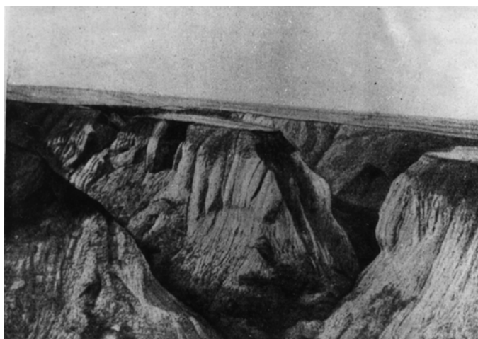
Рис. 20. Овраг в лёссовых грунтах
