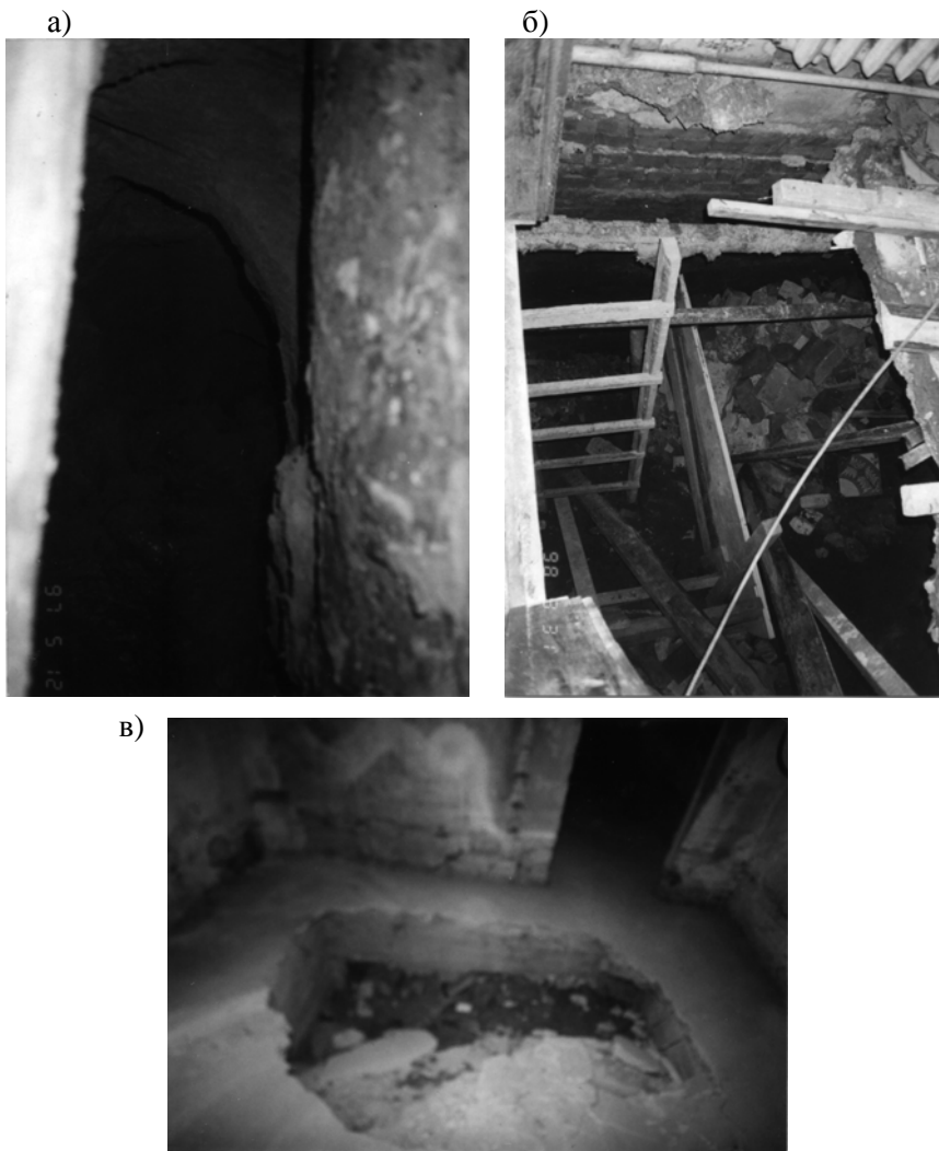
Рис. 44. Суффозионные полости за траншейной подпорной стеной гаражей «Атланта» по пер. Ольшевского (а) и провалы под полами в здании «Беларустуриста» на ул. Заславской (б) и между ростверками многоэтажного жилого дома по ул. Казинца (в) в г. Минске
