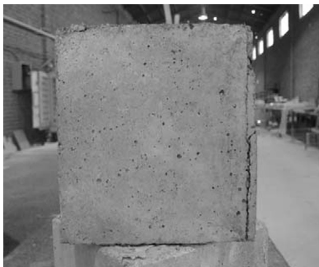
Рисунок 11. Поры, образовавшиеся на поверхности бетона во время выхода пара
