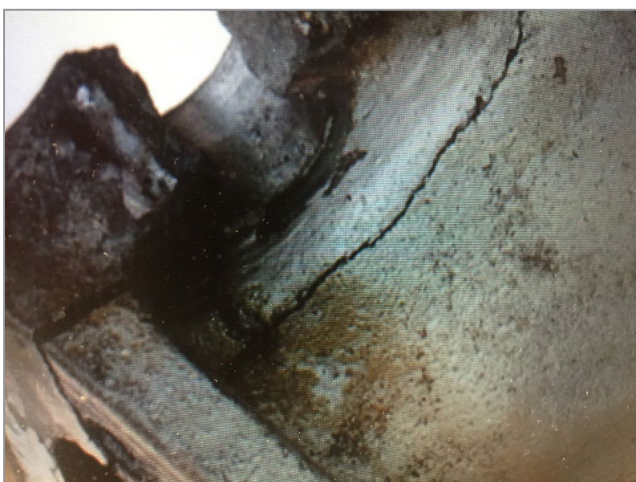
Рис. 3. Трещина в отливке «станина», возникшая в месте сопряжения ребра жесткости с конструктивным приливом
