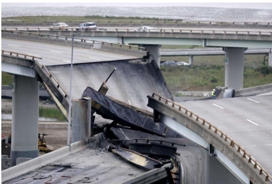
Рисунок 1 – Обрушение пролетного строения
