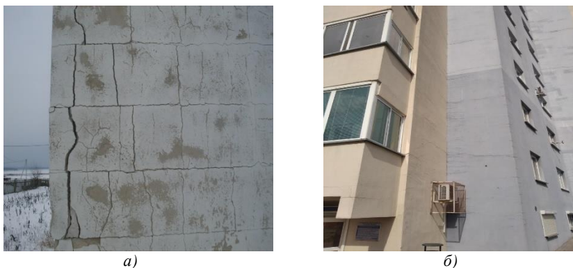
Рис. 1. Дефекты на стенах жилых домов в г. Минске: а) – ул. Грушевская, 91; б) – ул. Притыцкого, 91
