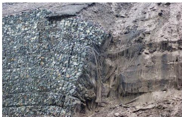
Рис. 8. Разрушение габионной подпорной стенки в результате допущения ошибок при проектировании или при монтаже конструкции
