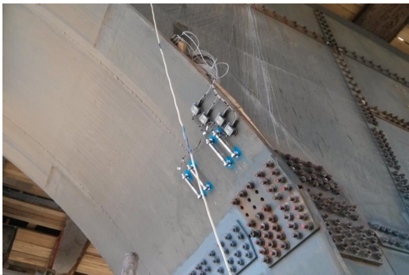
Рис. 5. Датчики системы мониторинга, установленные в надстройке опоры №4. 05.04.2016
