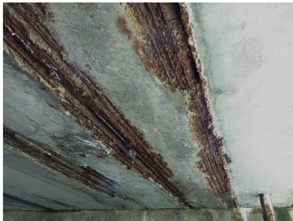
Рис. 1. Разрушение бетона сплошной плиты пролетного строения, коррозия стержней рабочей арматуры, водоотводная трубка в теле плиты
