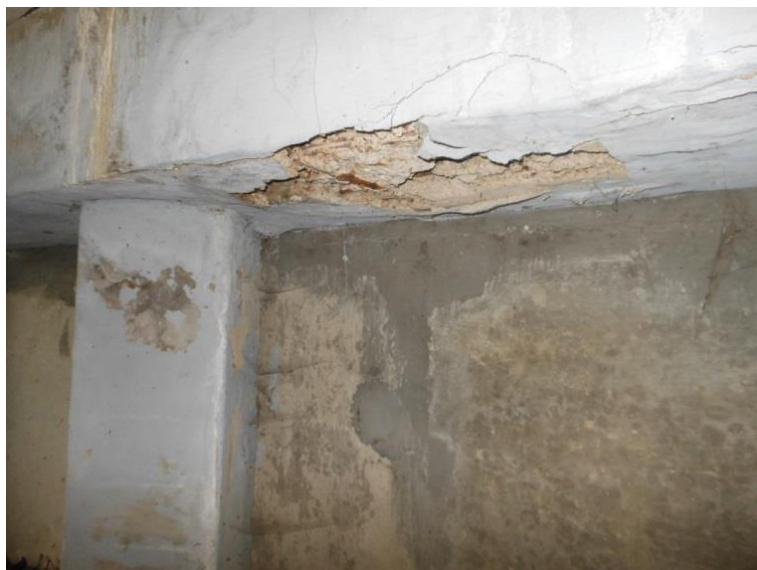
Рис.5. Повторное разрушение защитного слоя насадки после проведения ремонтных работ
