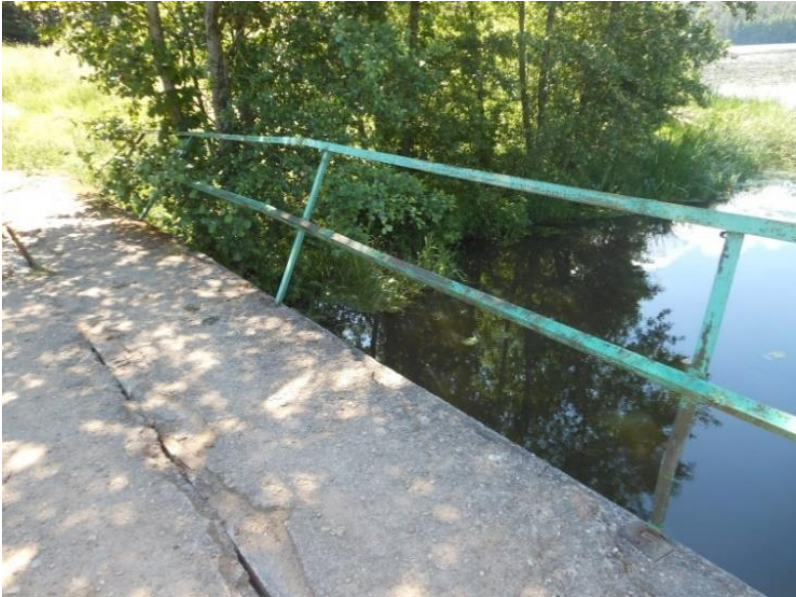
Рис. 1. Разрушение перильное ограждение
