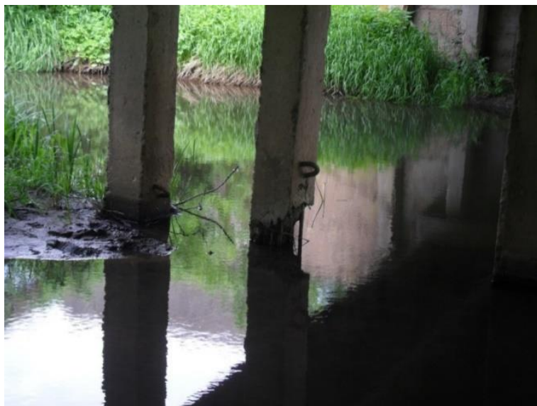
Рис. 3. Оголение и коррозия арматуры свай в зоне переменного уровня воды
