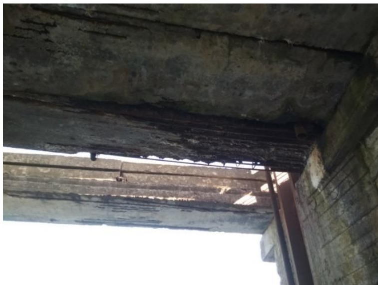
Рис. 2. Оголение и коррозия арматуры плитного пролетного строения моста-плотины над задвижкой шлюза
