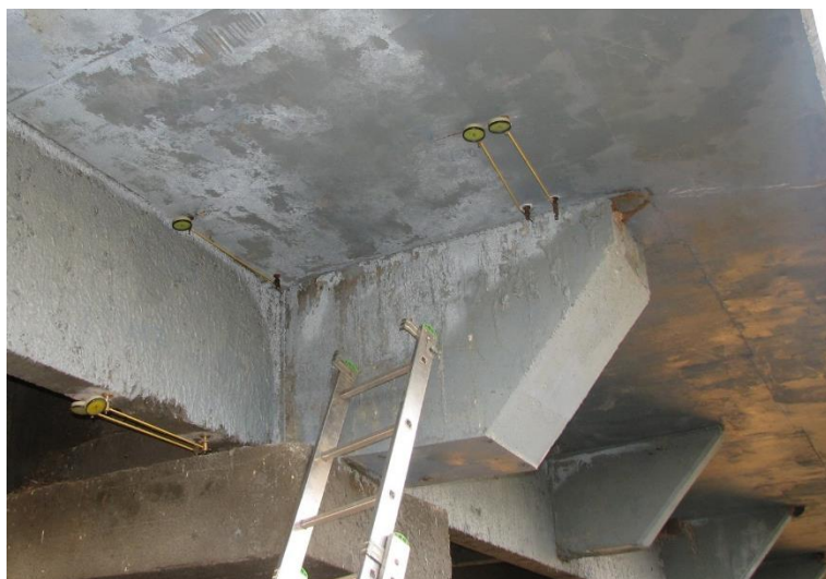
Рис. 6. Расстановка деформометров в приопорном сечении с низовой стороны
