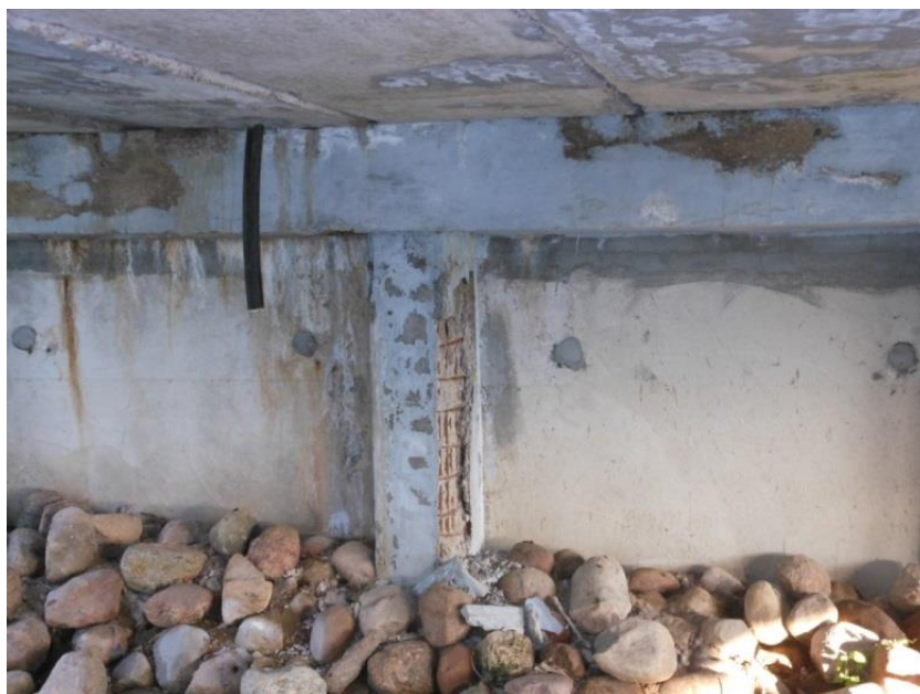
Рис. 4. Повторное разрушение защитного слоя сваи после проведения ремонтных работ
