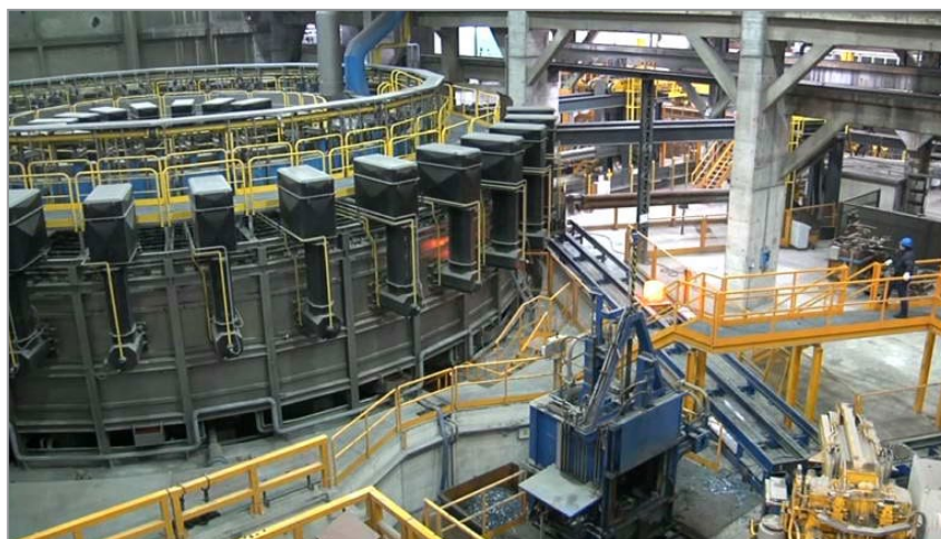
Рис. 6. Печь с вращающимся подом в составе автоматизированной линии по изготовлению железнодорожных колес на предприятии Lucchini (Италия)
