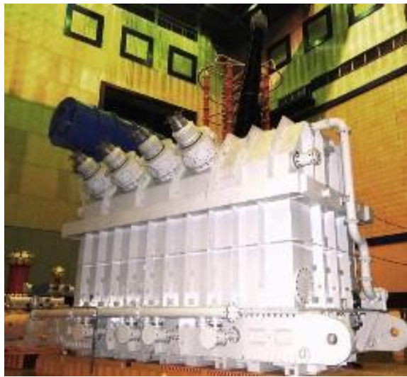
Рисунок 2 – Трансформатор ОРЦ-417000/750 мощностью 417 МВА на напряжение 750 кВ
