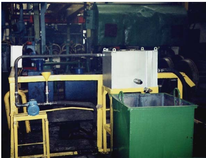
Рис. 1. Установка «Флотатор-У» производительностью до 2 м 3 /час на моечной машине
