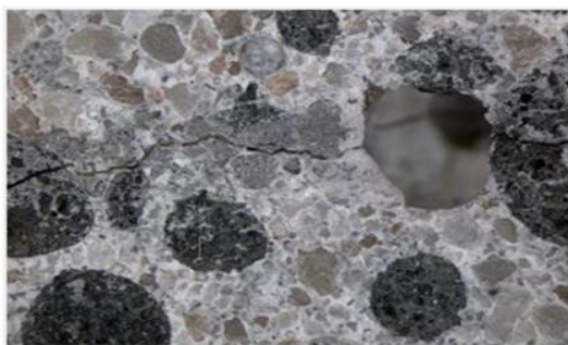
Рис.2 Трещины в структуре бетона
