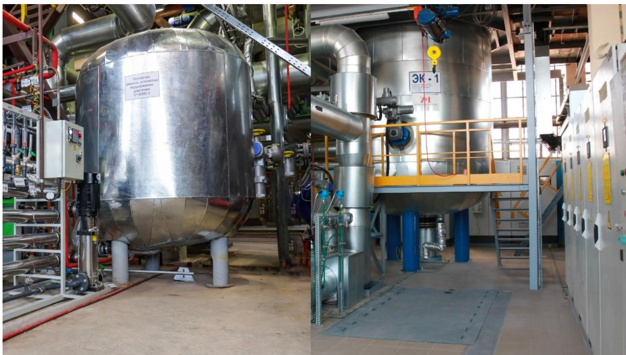
Рисунок 1 – Электрический котел на Гродненской ТЭЦ-2
