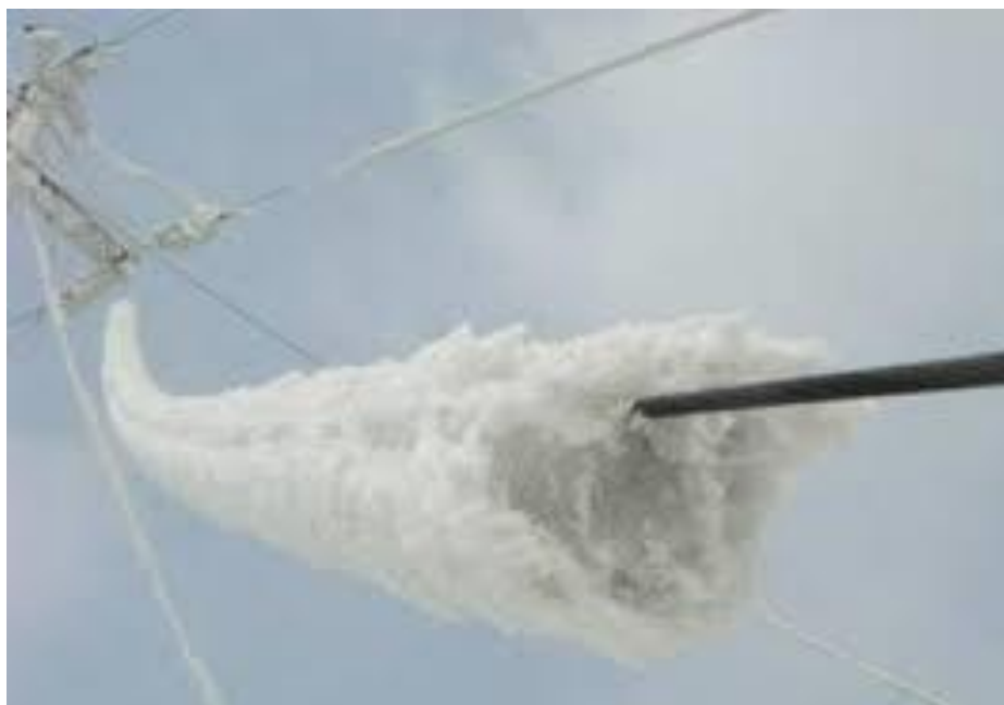
Рисунок 1 – Слой льда на проводах ВЛ
