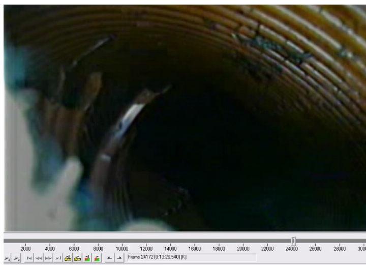
Рис. 5.41. Повреждение сбросного трубопровода с водоема-копани 2 участка 9
