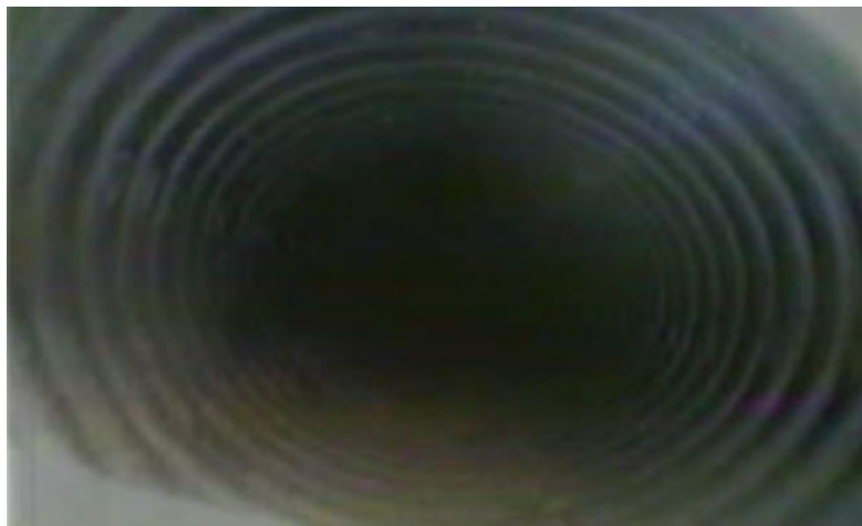
Рис. 5.43. Состояние коллектора 26-2-1 после промывки
