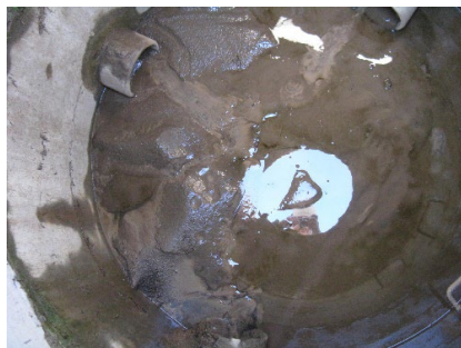
Рис. 5.30. Заиление смотрового колодца на участке 6 в 2007 г.
