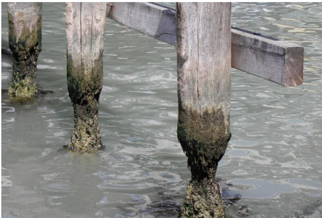
Рисунок 1 – Гниение свай деревянного моста в воде
