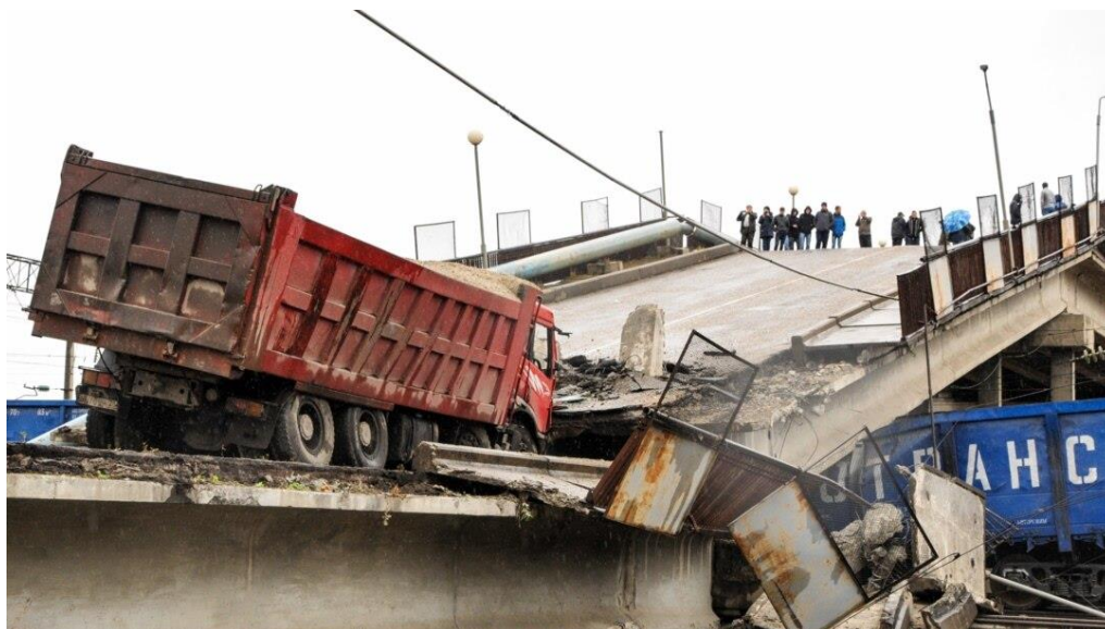
Рисунок 3 – Обрушение моста в следствии потери устойчивости фундамента
