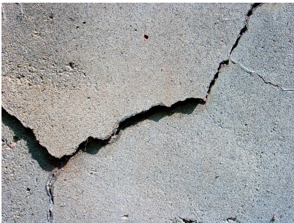
Рисунок 1 – Трещины в бетоне
