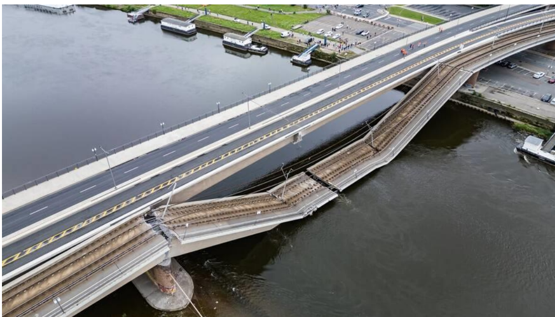
Рисунок 1 – Вид сверху на обрушившуюся часть моста
