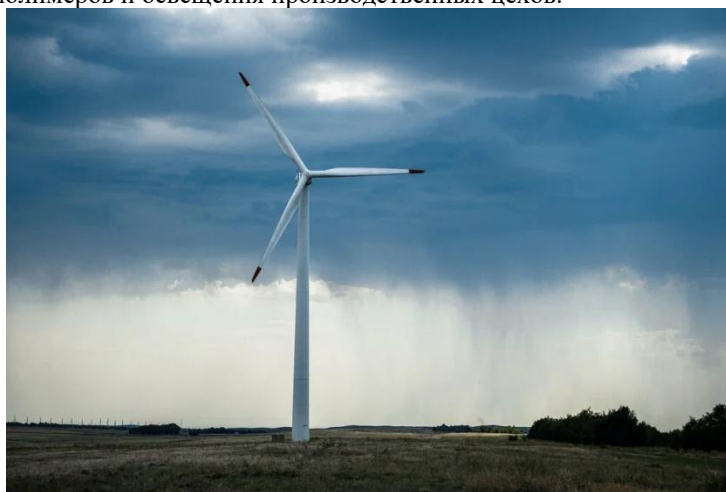
Рисунок 3. Ветроэлектрическая установка в г.п.Круглое
