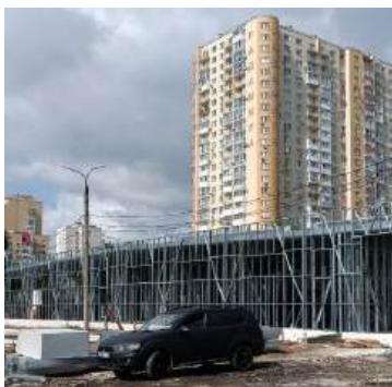
Рисунок 7 – Внешний вид каркаса быстромонтируемого здания. Мойка автомобилей в г. Самара, ноябрь 2024 г.
