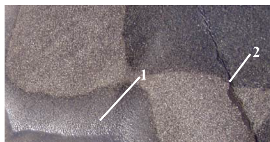
Рис. 5. Дефекты, вызванные нарушениями технологии выполнения кровельных работ: 1 – вздутия между слоями кровельного рулонного ковра; 2 – отслоения в местах нахлестки полотнищ
