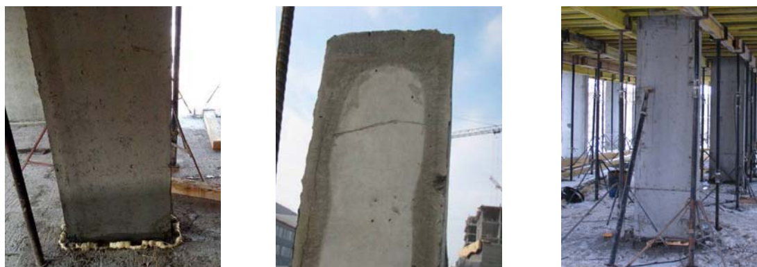
Рисунок 1 – Примеры потемнений переохлажденных слоев бетона, вызванные их переувлажнением
