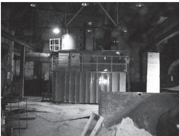
Рис. 4. АБХУ на ОАО «Гидропривод» (г. Елец)
