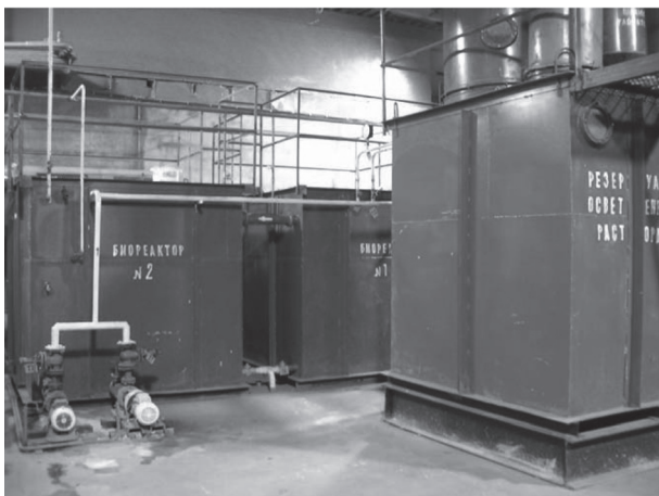
Рис. 2. АБХУ на ОАО «Автодизель» (г. Ярославль)
