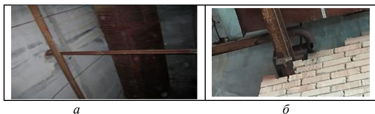
Рис. 2. Вид магистрального трубопровода на первом этаже ( а ) и отрезка трубы в помещении ПАА с коррозионными повреждениями ( б )
