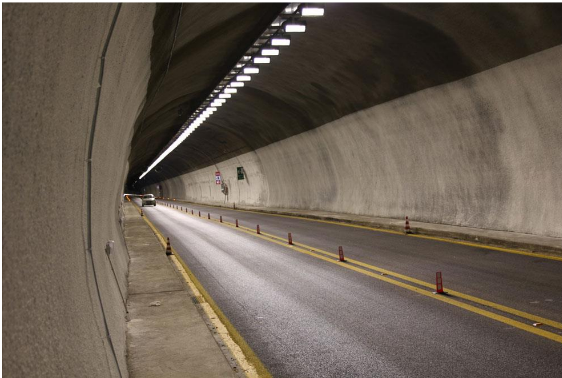
Рисунок 13 – Пример освещения тоннеля системой компании Arianna
