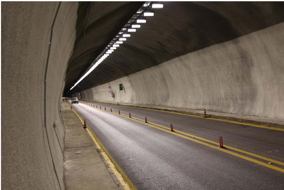
Рисунок 13 – Пример освещения тоннеля системой компании Arianna
