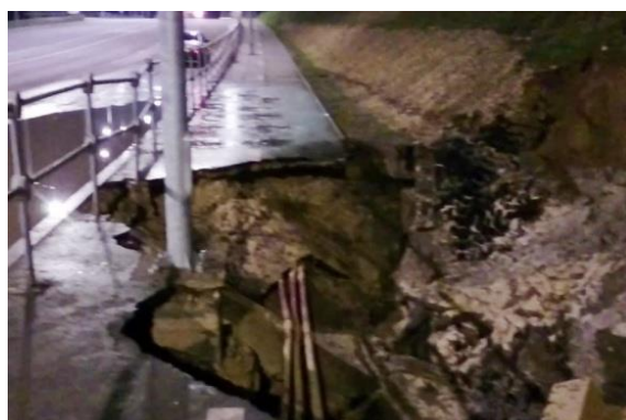
Рисунок 3 – Обрушения тротуарной зоны после ливневых дождей
