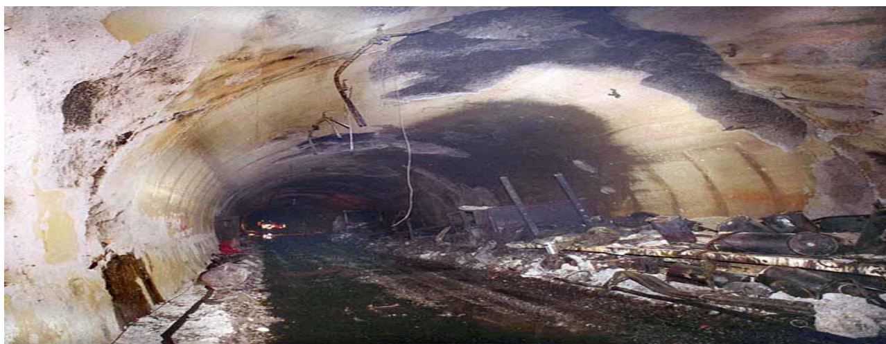
Рисунок 1 – Тоннель Монблан после пожара
