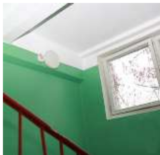
Рисунок 3 – Установленный датчик движения в подъезде
