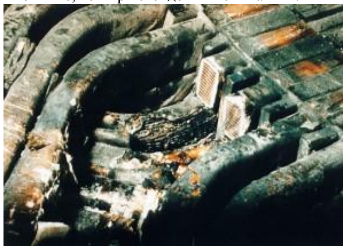
Рисунок 1. Повреждения изоляции обмоток статора
