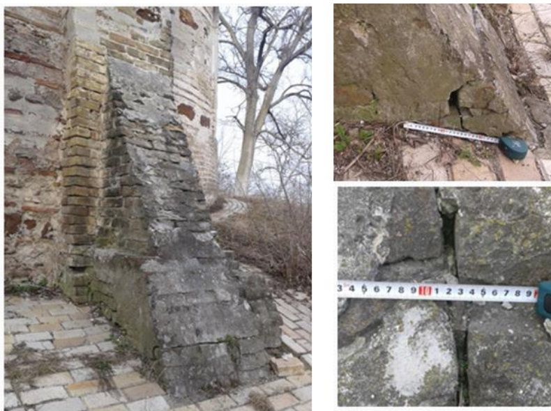
Рис. 5. Деформации контрфорса под южной стеной апсиды
