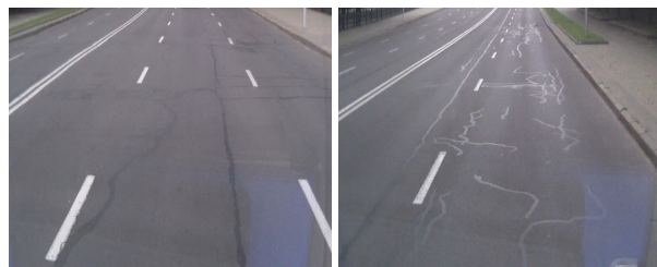
Рис. 1. Общий вид усталостных разрушений
