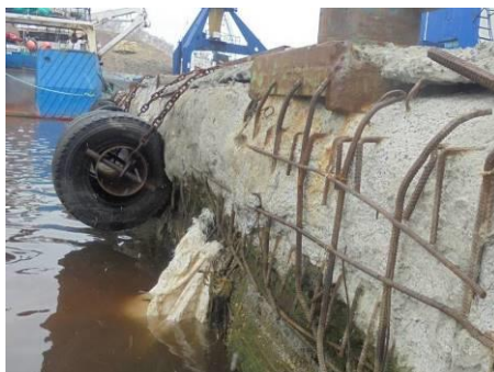
Рис. 1. Коррозия в зоне переменного уровня воды (порт Посьет)
