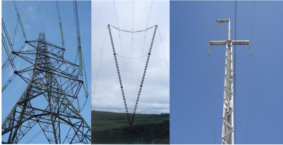
Рисунок 5. Металлические опоры воздушных линий
