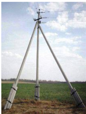
Рисунок 3. - Железобетонная опора 10кВ.
