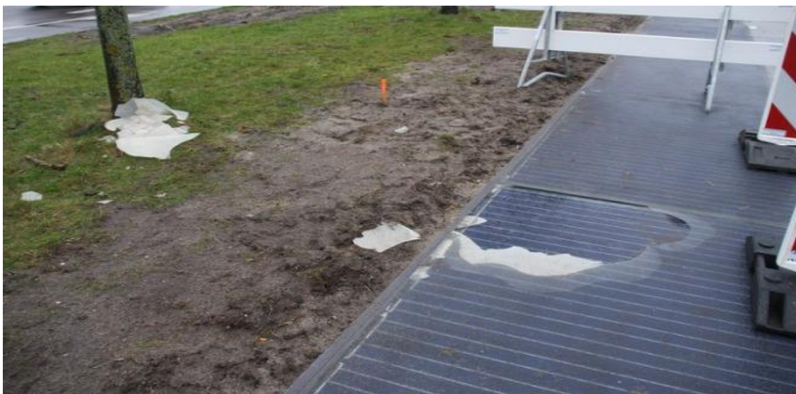
Рисунок 2. Дефекты участков покрытия SolaRoad
