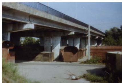
Рис. 1. Загромождение гаражами подмостового пространства путепровода по ул. Пионерской в г. Бресте (июль 2008 г.)
