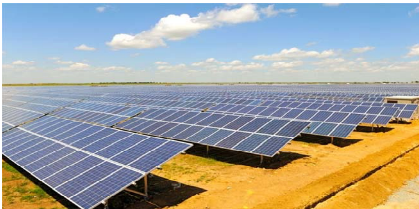
Рис. 2.22. Фотопреобразователи солнечной электростанции
