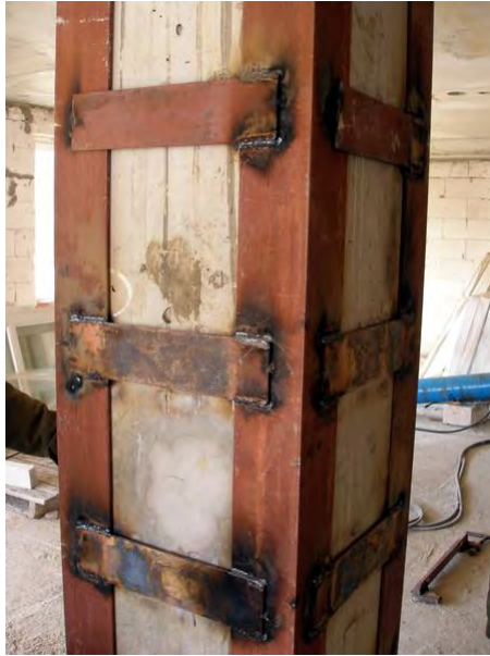
Рис. В.3 – Усиление колонны, не обеспечившей проектных показателей прочности, стальным бандажом
