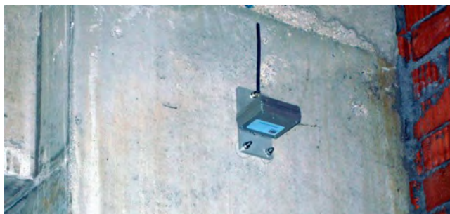
Рис. Д.2 – Расположение сенсоров ID-5...ID-8 (CMS-2D-R) в плане оборудования 7 этажа: на фото показан датчик ID-07
