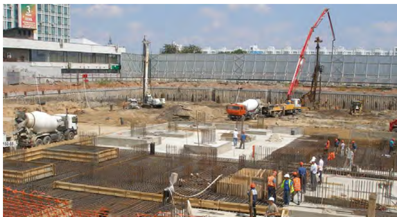
Рис. 9.5 – Общий вид строительной площадки: вид объекта в июне 2015 г. (вверху); строительная площадка в октябре 2013 г. (внизу)
