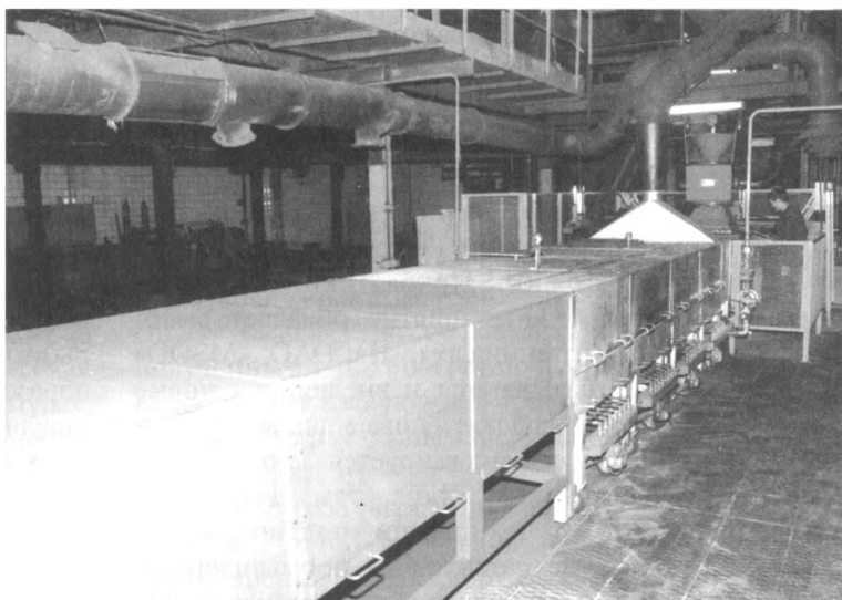
Общий вид линии ТЕРМОШОК
