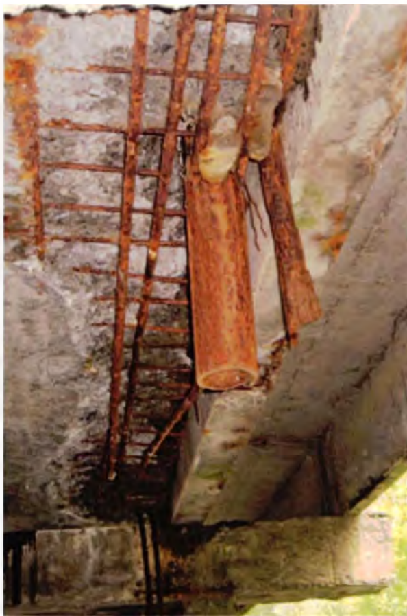
Рисунок 1 – Разрушение бетона, разрыв рабочей арматуры в местах установки водоотводных труб- ков крайней плиты пролета № 2 моста через р. Двиноса на км 61,142 автомобильной дороги М-3 Минск – Витебск
