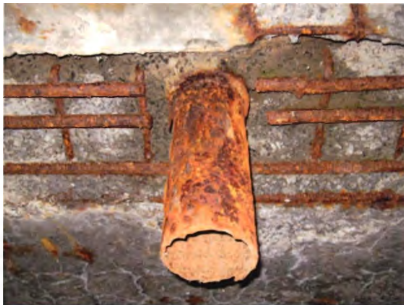
Рисунок 2 – Разрушение бетона, разрыв рабочей арматуры в местах установки водоотводных трубок крайней плиты пролета № 3 моста через р. Диражня на км 61,430 автомобильной дороги М-3 Минск – Витебск
